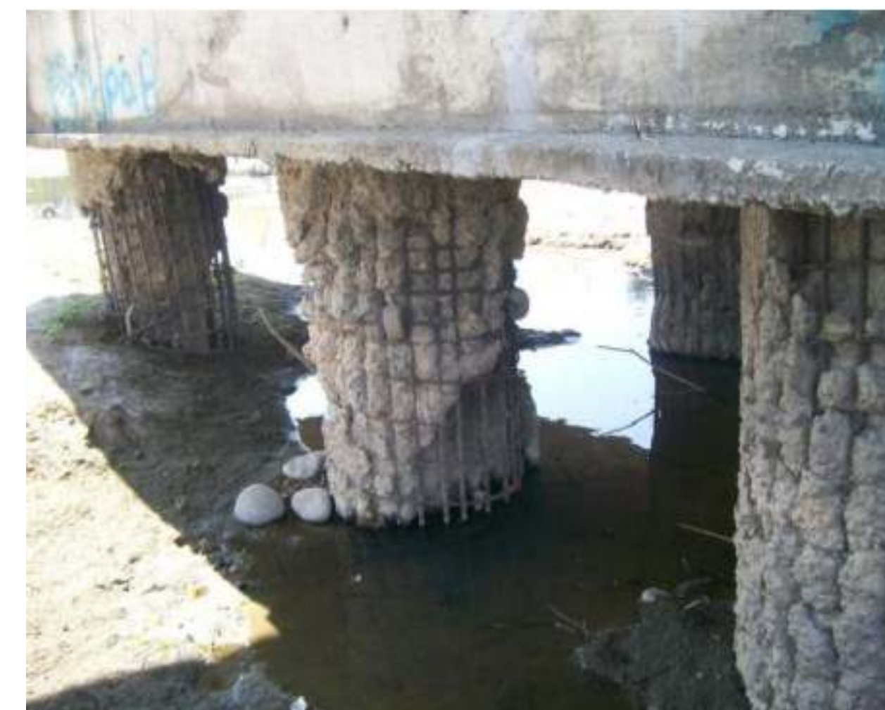
Figura 5.- Vista de socavación local, puente Pijijiapan 2017
